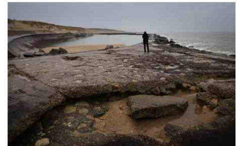
Les « piscines », des ouvrages de défense contre l'érosion sur la façade océanique entre Soulac-sur-Mer et Le Verdon . Après quatre-vingts ans de service, les dégradations sont légion. Laurent Theillet / SO
